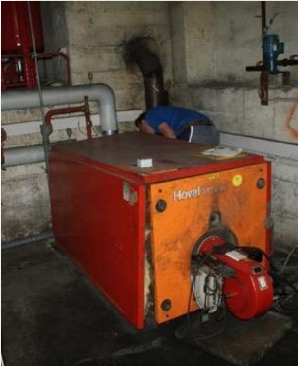
Quelle: Kurs der Kantone Luzern/Aargau „Heizungs-Check“
