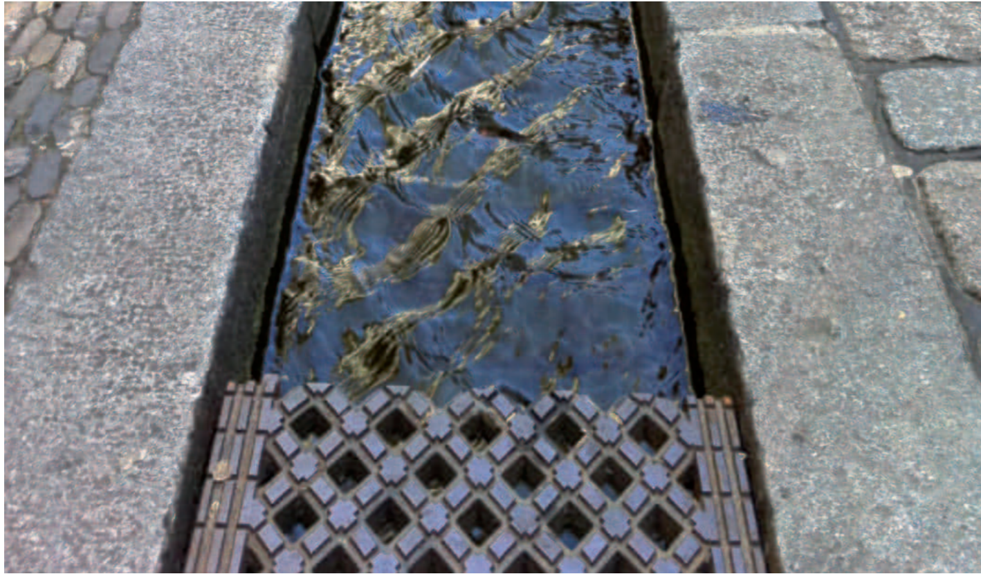
offene Entwässerungsrinne mit Abdeckung
