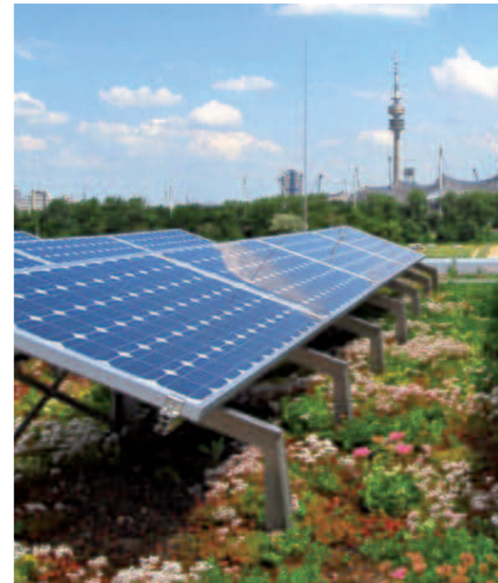
PV-Anlage mit extensiver Dachbegrünung
