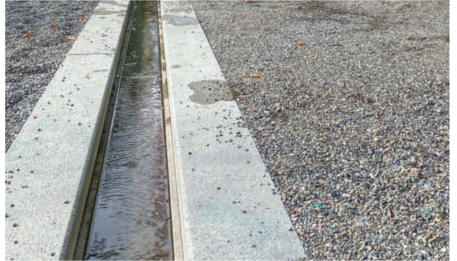
offene Entwässerungsrinne ohne Abdeckung
