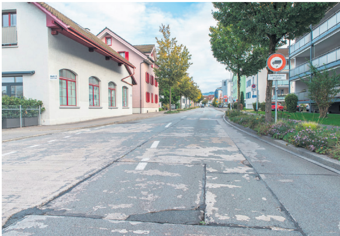
Die Zugerstrasse (hier beim Abzweiger Landhausstrasse) weist grosse Belagsschäden auf und muss saniert werden.
